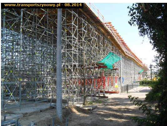
Fot. 91 Przykład budowy estakady w Krakowie w ramach Krakowskiego Szybkiego Transportu - 2014 r. (źródło: https://www.transportszynowy.pl/fotorelacje/krestakada-tram )
