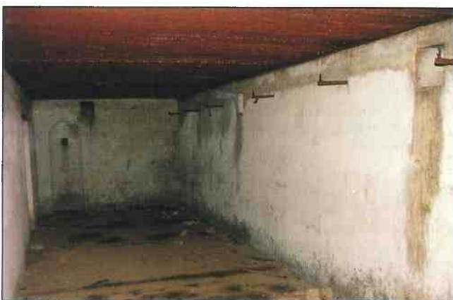
Wnętrze izby pogotowia w bloku schronu głównego, widoczna stalowa konstrukcja stropowa z czasu modernizacji (fot. J. Kubicha, 2004)
